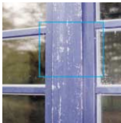
Abbildung: Lackabriss durch Einsatz eines zu stark klebenden Gewebebandes. Empfehlung: tesa Oberflächen- schutzband 4438 UV
