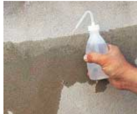
Abb.: Zu hohe Saugfähigkeit - Grundiermittel erforderlich
