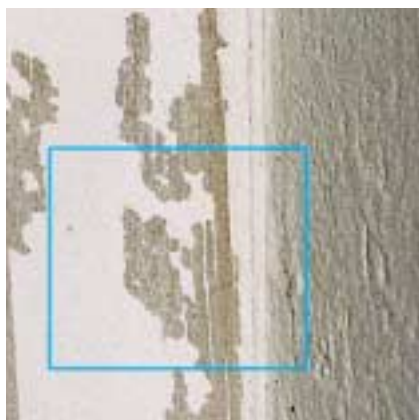
Abbildung: Lackabriss eines nicht durchge- trockneten Acryllackes
